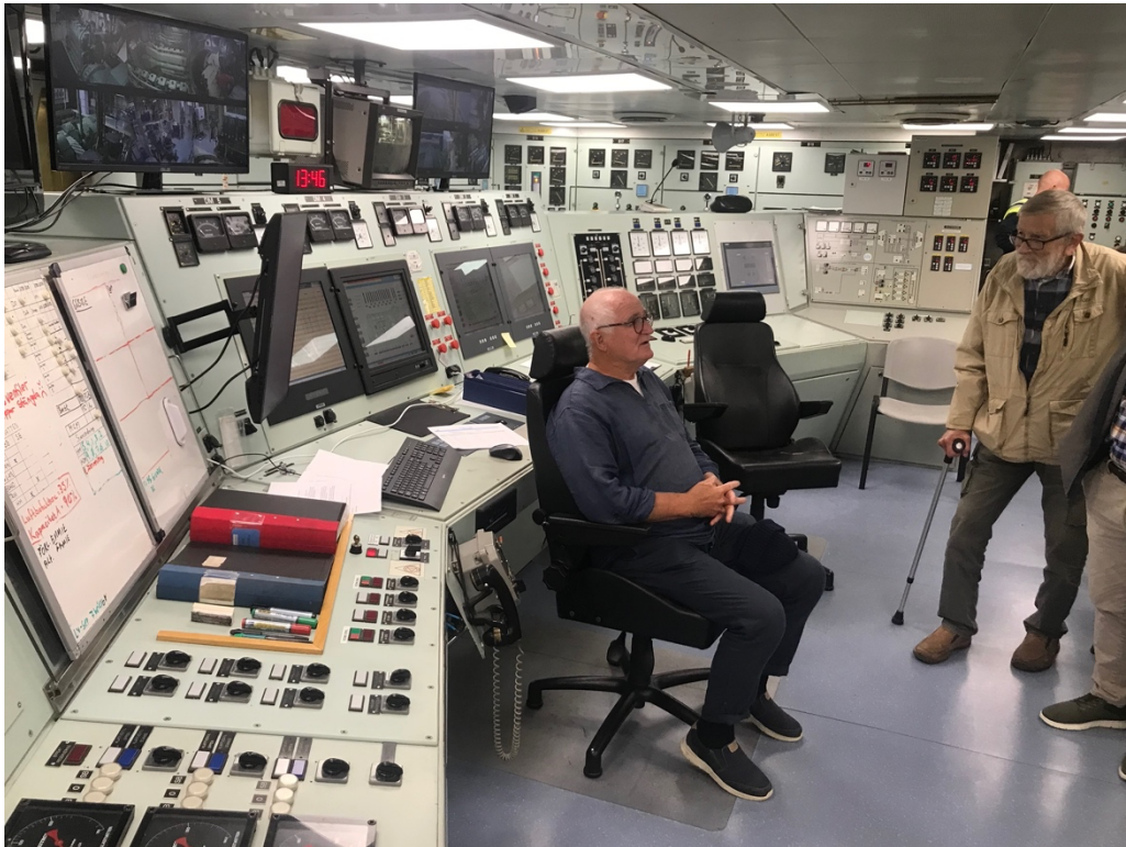
Christer Johansson och Vambola Kallaste i maskinkontrollrummet.
