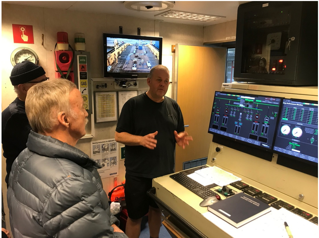
En del av maskinkontrollrummet och maskinchefen Nils Nielsen.
